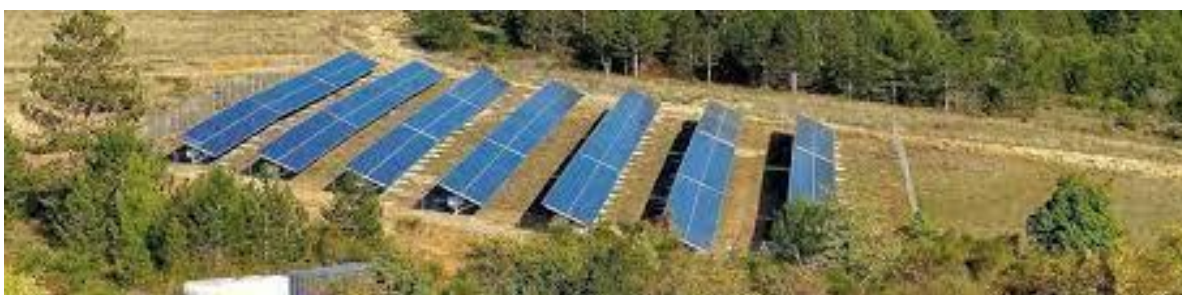
FIGURE 4: PARC CITOYEN PHOTOVOLTAÏQUE DE LUC SUR AUDE
